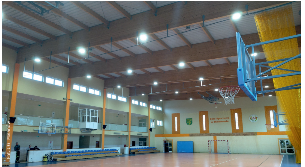
Energooszczędne oświetlenie w hali sportowej
